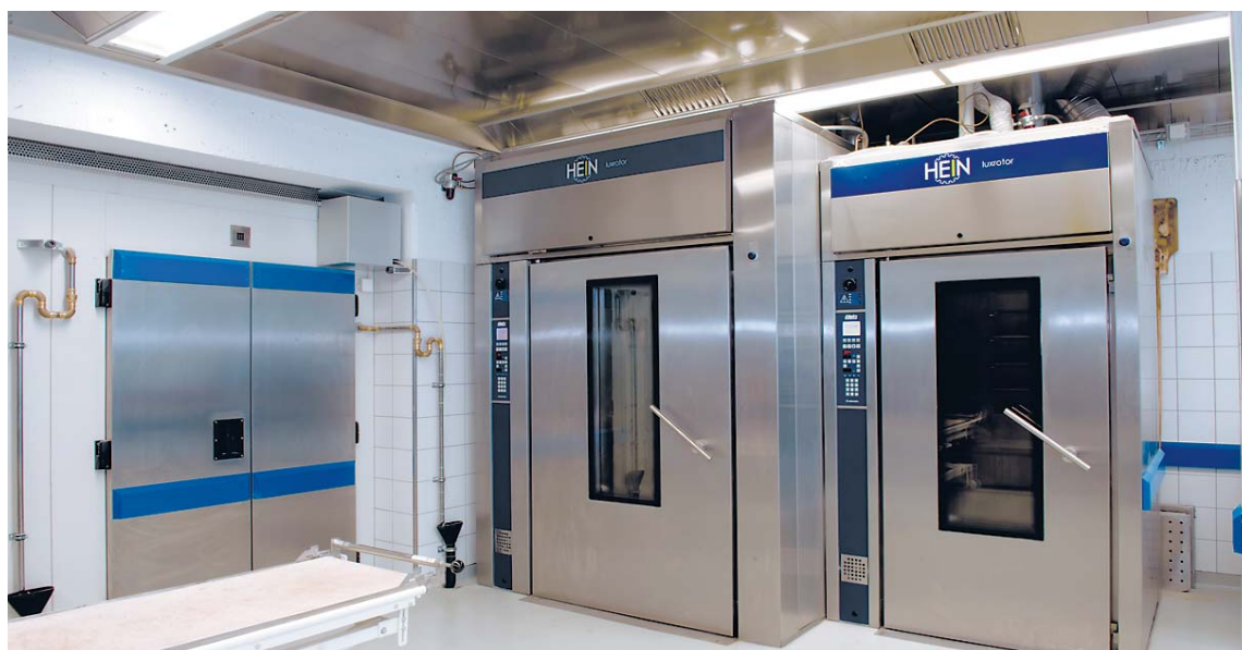
La zona di cottura con la ventilazione incorporata nel soffitto.
